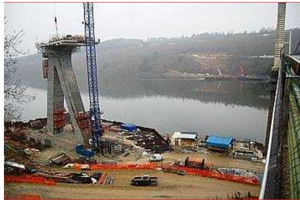
Côté Crozon, le premier pylône du nouveau pont de Térénez qui culmine à 40 mètres est achevé.
