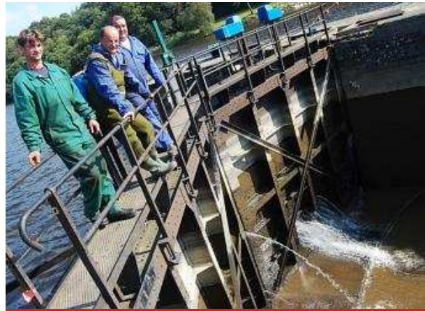
Paul Autret, Yann Vaillant et Rémi Bernard, du Smatah, ont réparé l'écluse de Guilly-Glaz. Elle fonctionne. Mais nécessite encore « des travaux de détails » pour combler les fuites visibles sur la photo.
